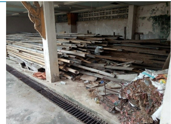
จุดที่ 2 พื้นที่ใต้ศาลา วันที่คาดว่าจะปรับปรุง 14 กันยายน พ.ศ. 2561 แนวทางที่จะปรับปรุง กวาด-ล้างทำความสะอาด, เก็บสิ่งปฏิกูลออกนอกพื้นที่ ผู้รับผิดชอบ นายสงกรานต์ ถนัดศรี เจ้าหน้าที่ อบต.คลองใส
